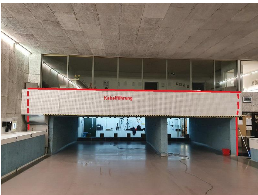
Bild 14: Kabelführung oberhalb des Lüftungskanals
