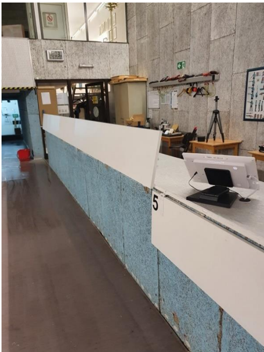
Bild 11: teilweise hochgeklappte Ableitplatte
