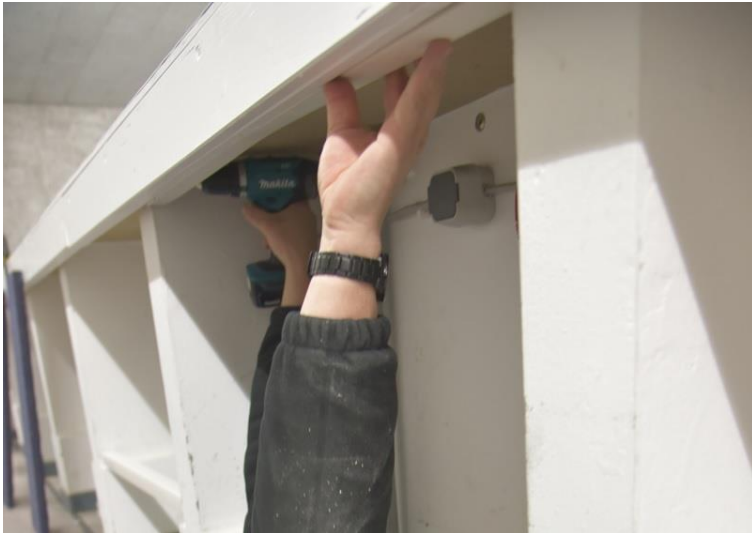
Bild 13 Kabelkanal und bestehende Elektroinstallation unterhalb der Tischplatte (Bauphase)
